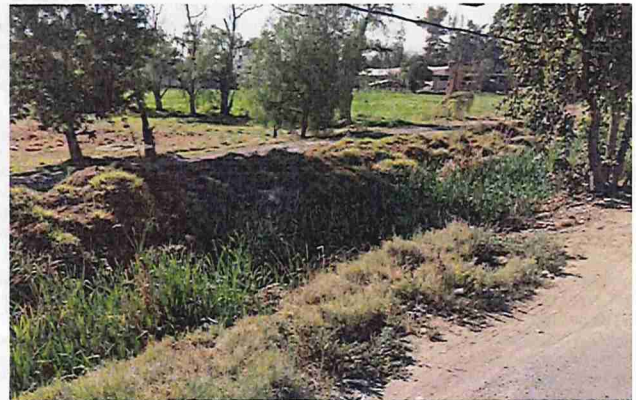
Ilustración 14. Canal Superficial de Riego.
